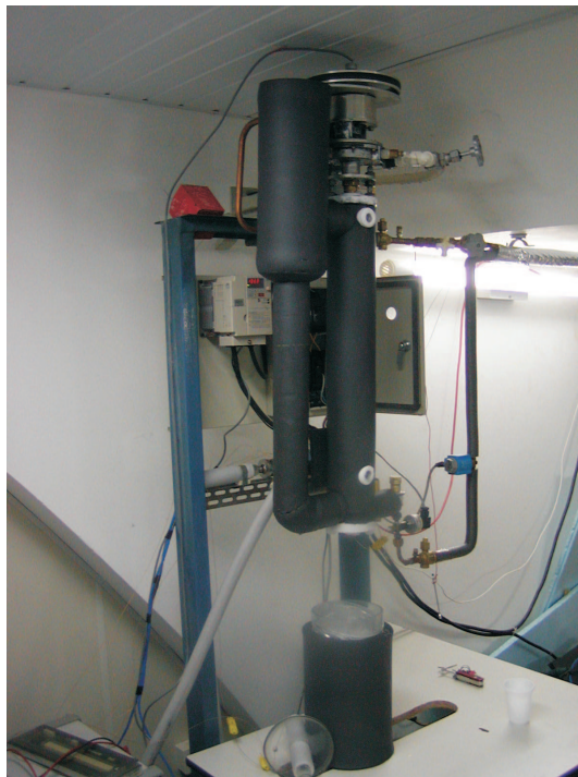
Figura 4: Fotografia do gerador de pasta de gelo.
